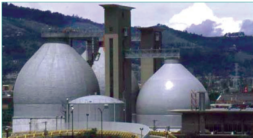
Fig.1: Anaerobic digesters at Empresas Publicas
